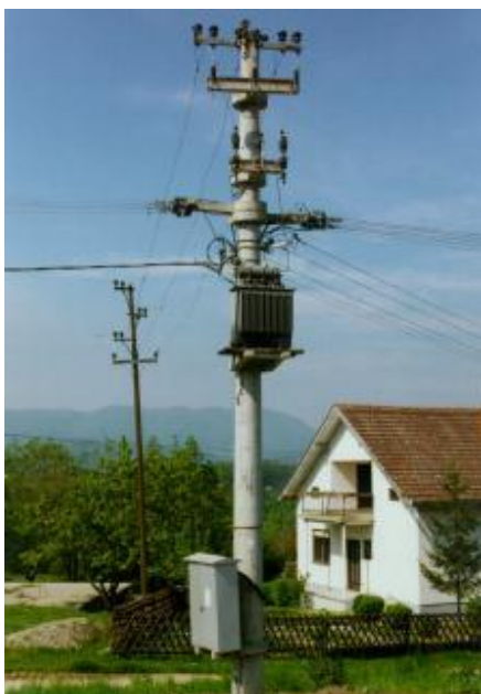
Slika - STS 10/0,4kV; na betonskom stubu
